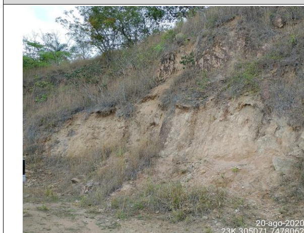
Foto 01 Vista das feições erosivas no talude.
