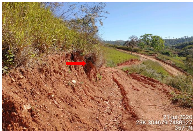
Foto 02 Solo se desprendendo do talude devido a falta de sustentação.
