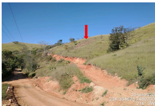
Foto 01 Vista geral das feições erosivas.
