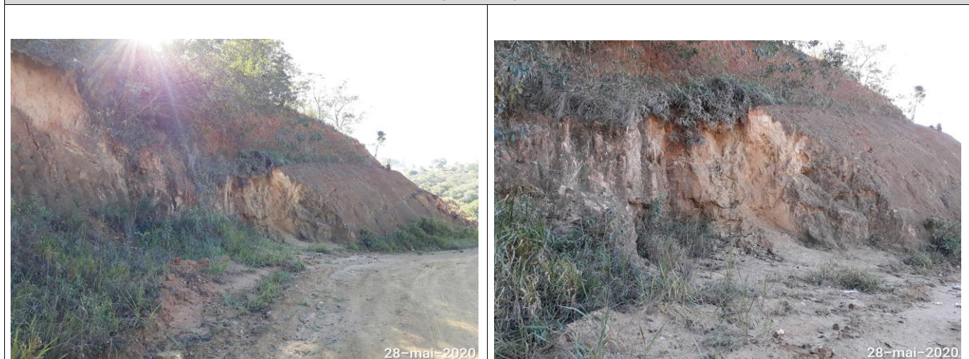
Foto 01 Vista das feições erosivas no talude. Foto 02 Detalhe do deslocamento rochoso/terroso.
