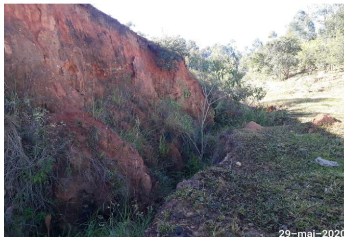
Foto 02 Detalhe do processo erosivo.
