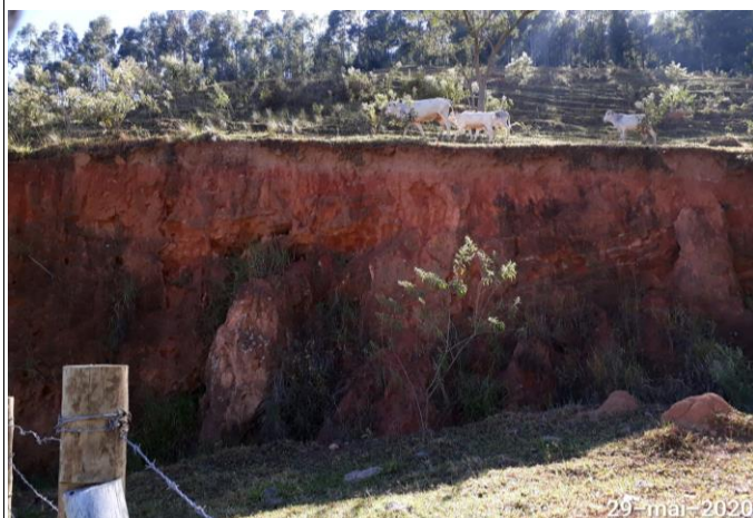
Foto 01 Vista das feições erosivas no talude.
