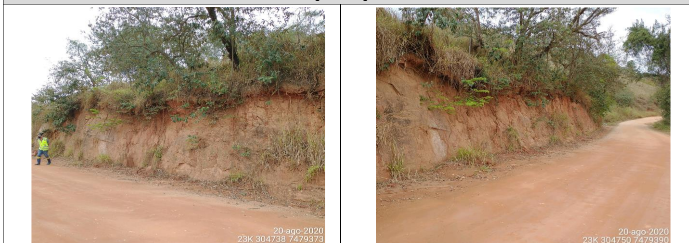
Foto 01 Vista geral do passivo ambiental Foto 02 Detalhe do processo erosivo.
