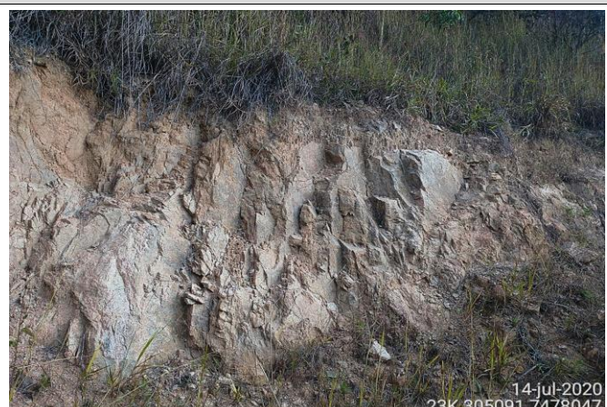
Foto 02 Detalhe do deslocamento rochoso. 14-jul-2020 23K 305091 7478047
