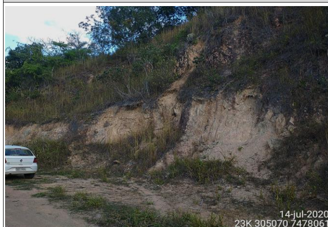
Foto 01 Vista das feições erosivas no talude. 14-jul-2020 23K 305070 7478061
